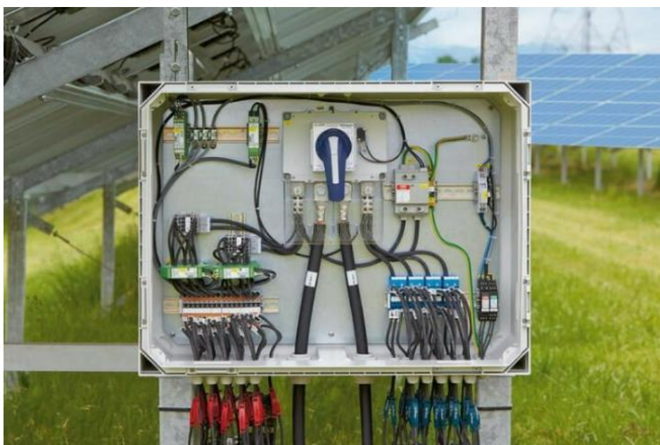
Figura 10 - Vedere asupra cutiilor de conexiune
