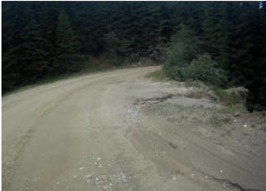
Figura nr. 36 Zona de interes a DJ 714 – starea actuală a drumului
